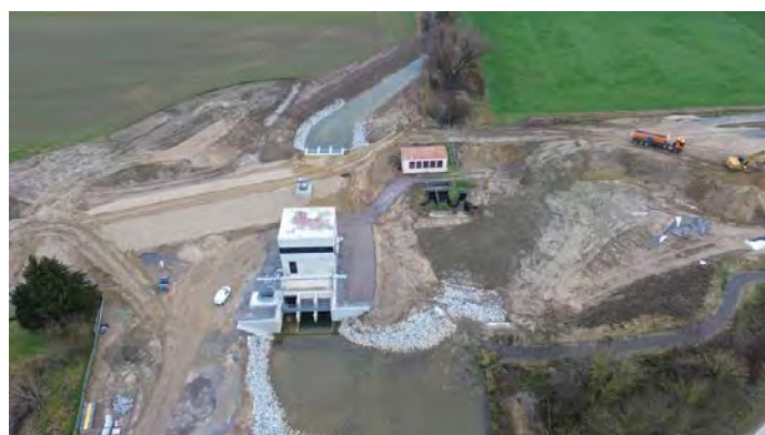
Vergleich altes und neues Pumpwerk
